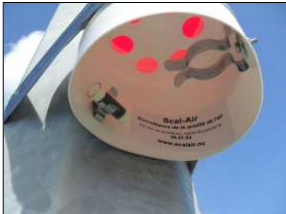
Figure 3 : Les supports d'éclairage public gérés par EEC et la Ville de Nouméa, ainsi que les poteaux OPT, sont généralement utilisés avec l'accord de ces partenaires pour fixer les boîtes
